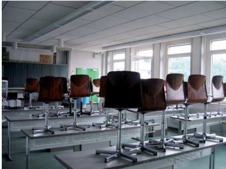
Abb. 4: Klassenraum mit Akustikdecke aus Mineralfaserplatten
